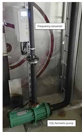
Mehrstufige HERMETIC Spaltröhrenmotorpumpe des Typs CAMh, die in der Versuchsanlage eingesetzt wird und mit einem drehzahlgeregelten Antrieb ausgestattet ist. (Bildmaterial: SINTEF Energy Research, www.sintef.no )
